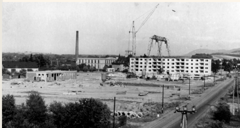
4 Výstavba prvního panelového domu ve Frýdku-Místku (ulice Beskydská), 1963. Foto: Muzeum Beskyd Frýdek-Místek.
