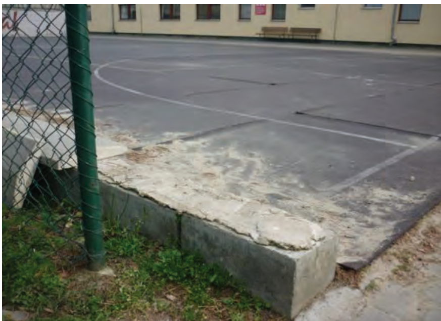
Obr. 7.2 Nechráněné betonové obrubníky na hřišti – riziko těžkého nebo smrtelného úrazu (Černá, Dzurenda, 2014)
