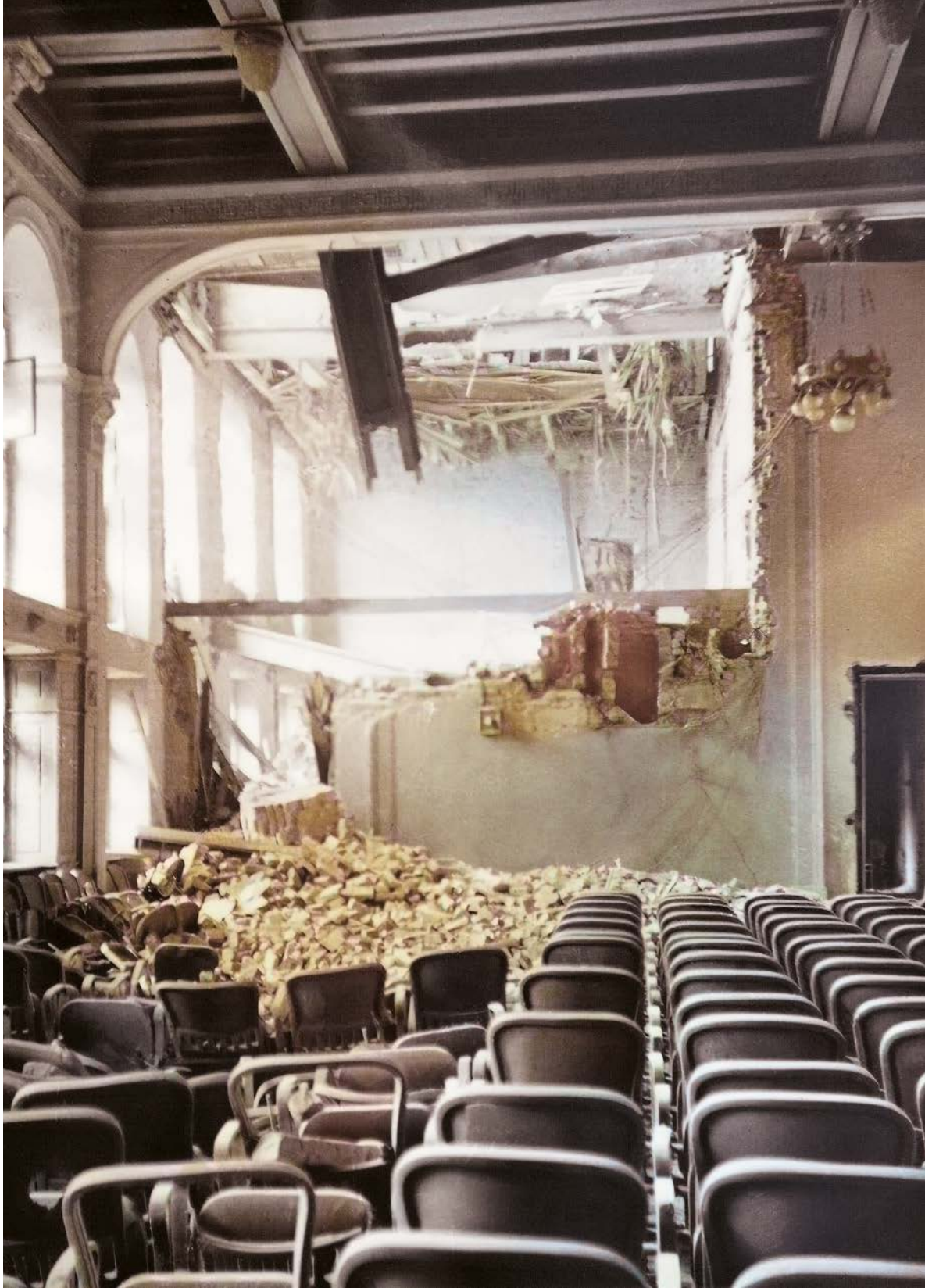
— Válečnými událostmi poškozená posluchárna LF, foto 1945, kolorováno
